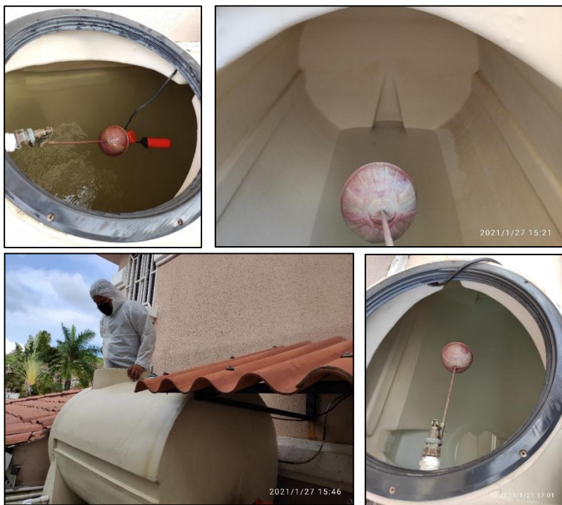
Figura 19. Tanque sucio con sedimentos (arriba), Técnico realizando mantenimiento de tanque (abajo izq.), Tanque limpio (abajo der.).
