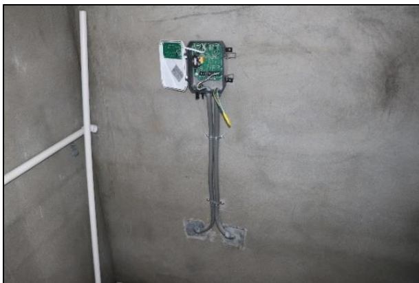
Figura 14. Panel de control de la bomba solar.
