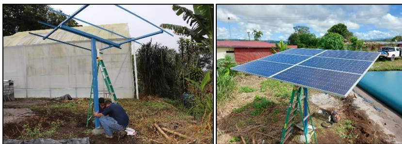
Figura 13. Paneles solares instalados para la generación de energía para el bombeo de agua.
