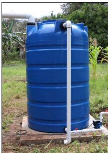
Figura 5. Tanques de PVC para almacenamiento de agua.
