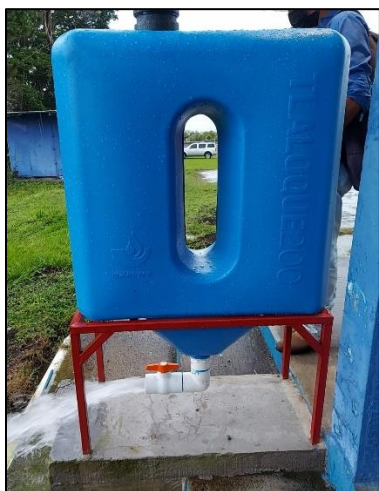
Figura 24. Drenado del separador de primeras lluvias.
